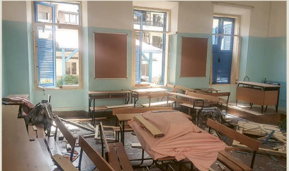
Die Klassenzimmer in der Schule der Vinzentinerinnen sind so stark beschädigt, dass sie nicht mehr genutzt werden können.
